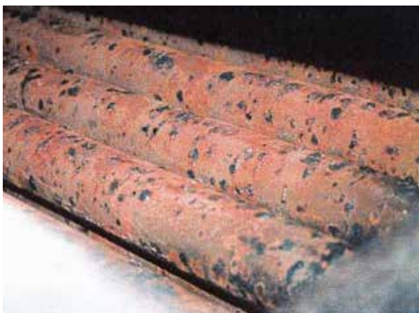
Foto de pitting (corrosión por oxígeno)
